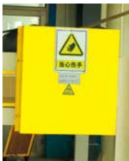
安全风险警示牌
